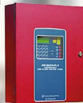
Central de Incendios
